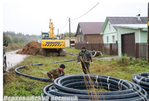
Проект «Народный бюджет», прокладка водопровода д.Наумиха
