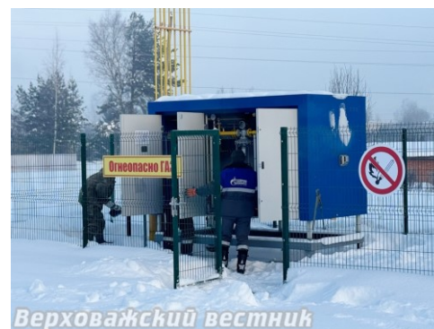
Газовая котельная в с. Чушевицы
