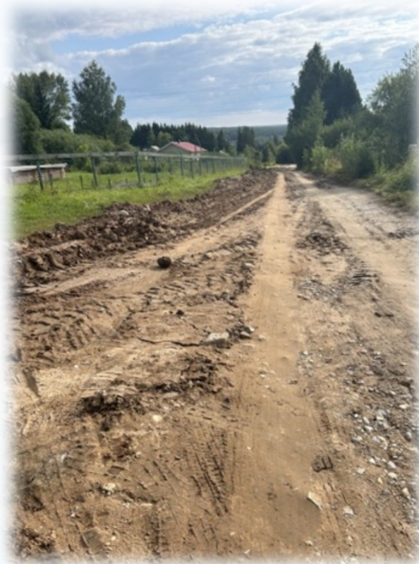
Ремонт водопровода на ул. Нагорная, ул. Весенняя, ул. Первомайская, ул. Подлесная с. Чушевицы
